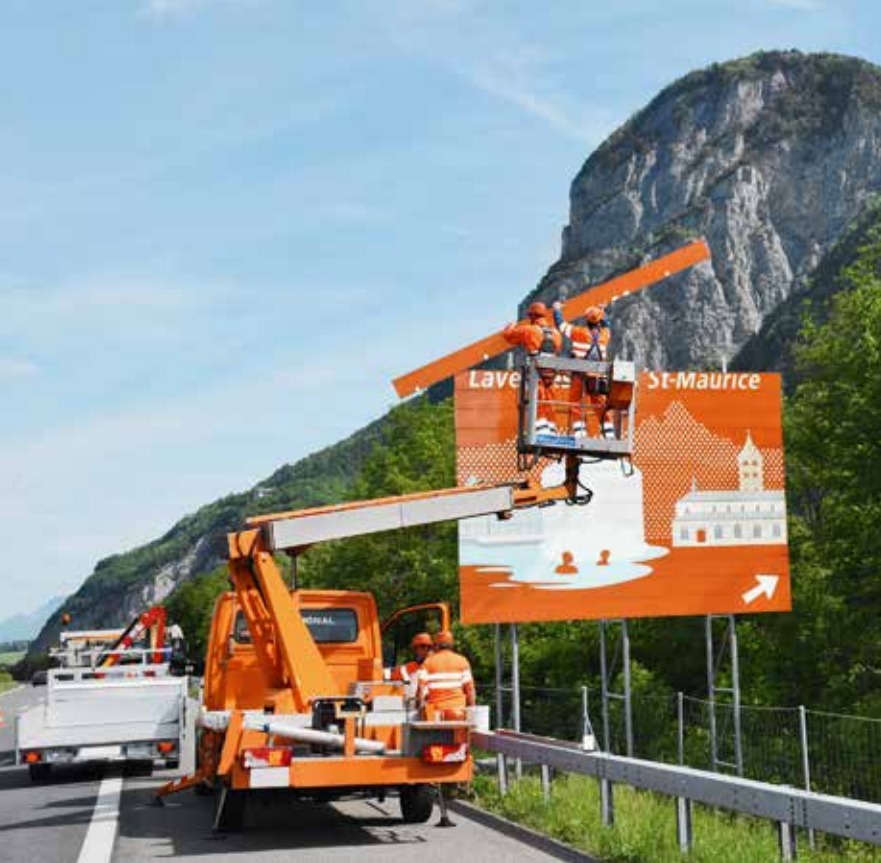
Secteur d'activité important de SIGNAL SA: fabrication et montage de panneaux routiers et de signalisation
